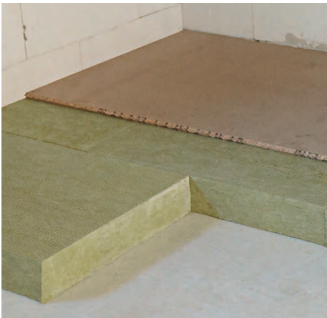
Für die gelegentliche Begehung reicht eine 19 mm starke Holzspanplatte als Abdeckung aus
